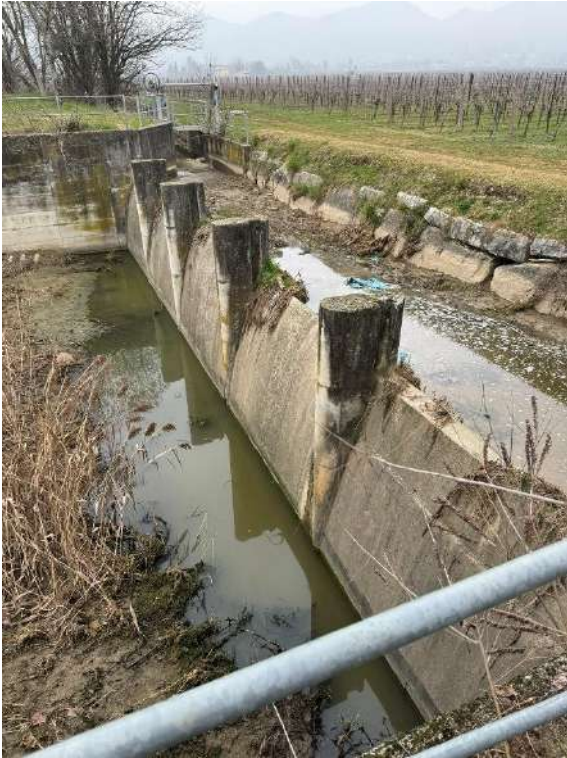
Foto 12 - Canale Ca'Mula ingresso cassa espansione
