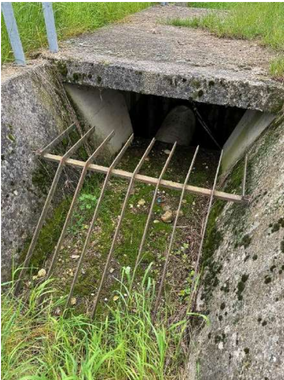
Foto 40 – Griglia su scolina a lato di via Piave
