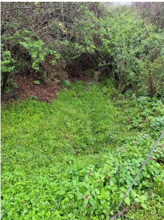
Foto 52 – Sbocco canalone su via Polin
