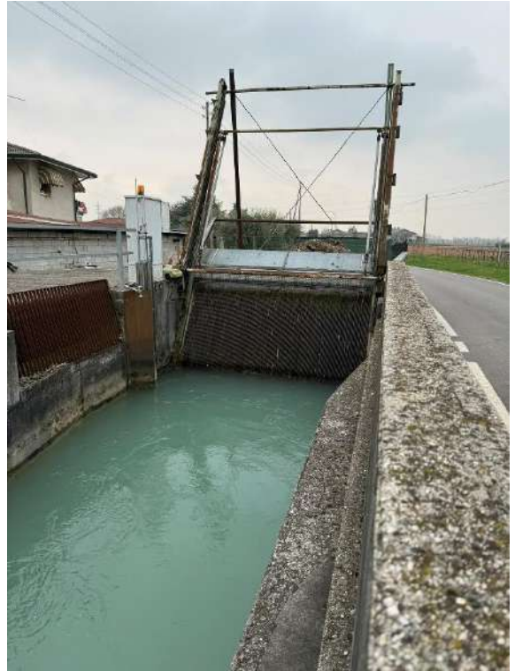
Foto 63 – Manufatto sgrigliatore su c. Moresca
